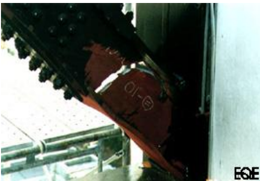
Figura 1.22 Daño en arriostramiento cerca de la conexión ( http://www.eqe.com/publications/kobe/building.htm )
