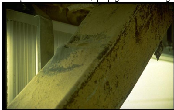
Figura 1.12 Pandeo local en arriostramiento ( http://nisee.berkeley.edu/eqiis.html )
