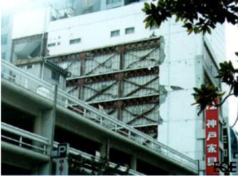
Figura 1.23 Pandeo de arriostramiento en edificio tipo lápiz ( http://www.eqe.com/publications/kobe/building.htm )
