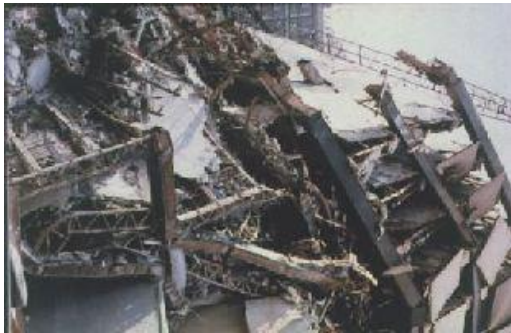
Figura 1.10 Edificio colapsado del Complejo Pino Suárez (Cortesía del M. en C. Del Valle)
