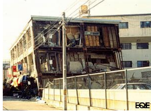
Figura 1.24 Desplome en edificio con base de marcos ( http://www.eqe.com/publications/kobe/building.htm )
