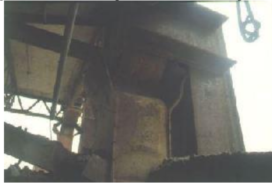
Figura 1.9 Pandeo en columna exterior (Cortesía del M. en C. Del Valle)
