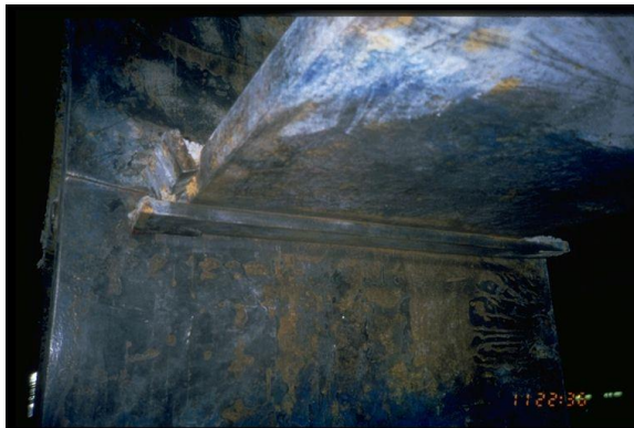
Figura 1.17 Fractura en el patín de la columna en la Conexión ( http://nisse.berkeley.edu/eqiis.html )
