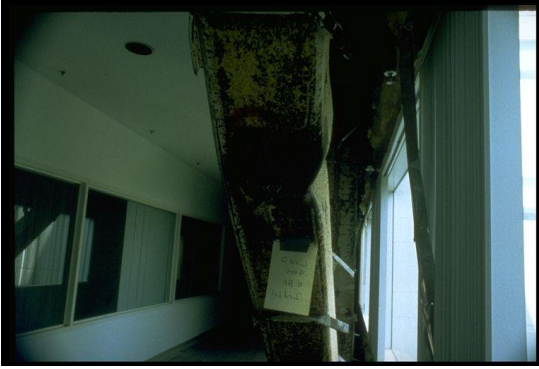
Figura 1.11 Fractura provocada por el pandeo en arriostramiento ( http://nisee.berkeley.edu/eqiis.html )
